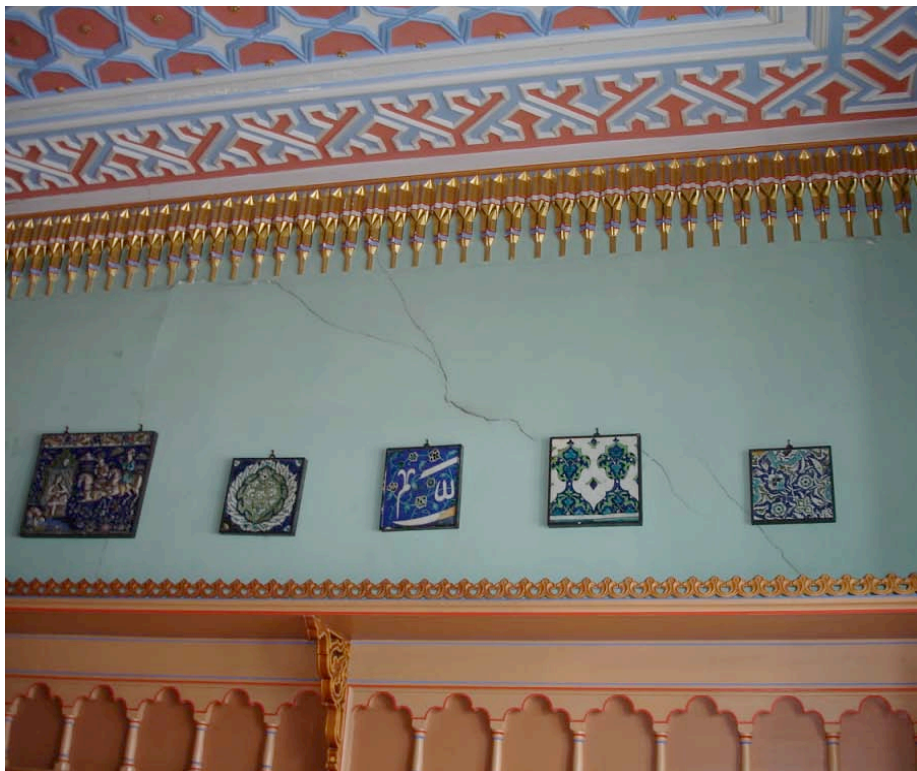
Schadhafte Stellen an der Nordwand des türkischen Rauchsalons
